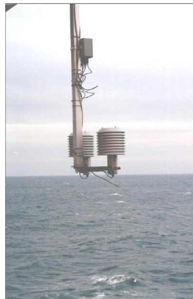
figuur 2b, opstelling met de schotelhut op een zeestation (Meetpost Noordwijk)
